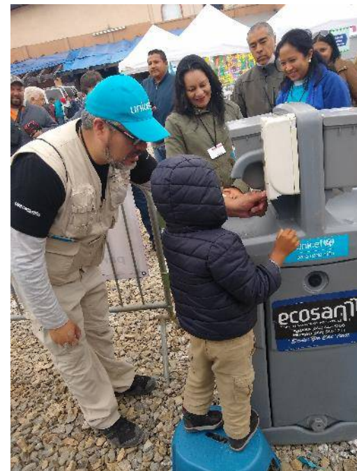
Figure 2 Infraestructura de agua y saneamiento instalada en albergue de Tijuana. Foto: ©UNICEF México
